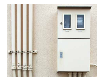
分電盤ボックス
